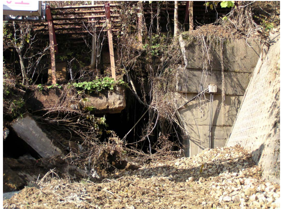
羽黒トンネルの損傷例
