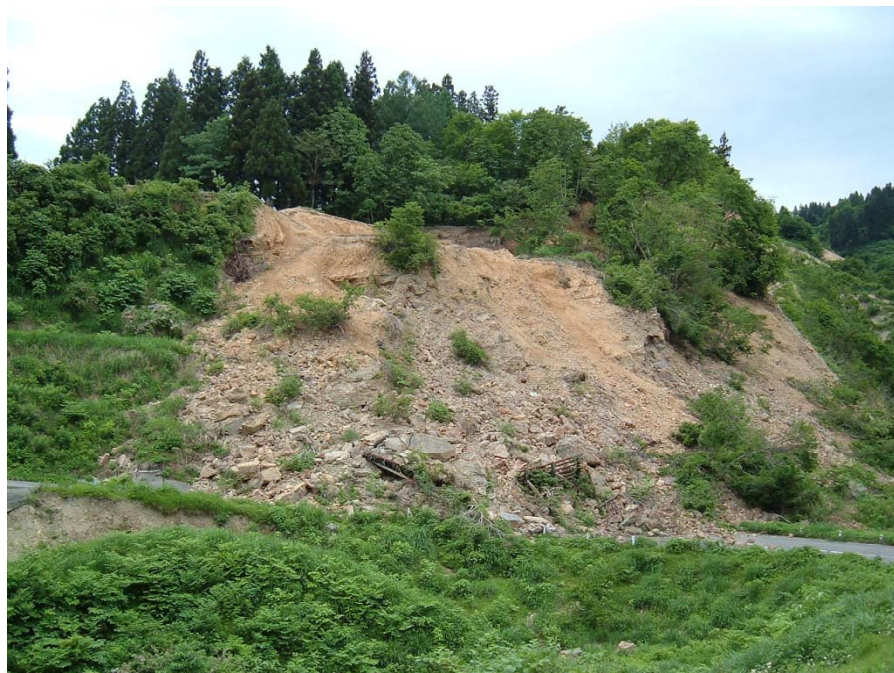
切土斜面の崩壊による雪崩防止柵の破壊
